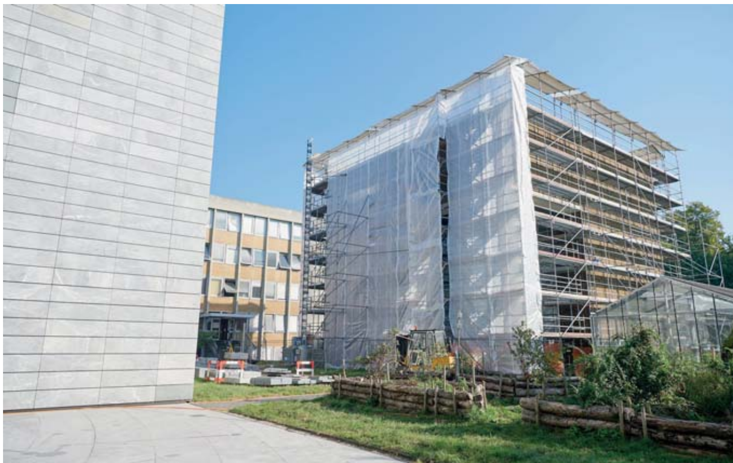
Le bâtiment de l'animalerie - ici vu du sud, avec ses échafaudages - sera doté de panneaux photovoltaïques au début du mois prochain. DAVID MARCHON
